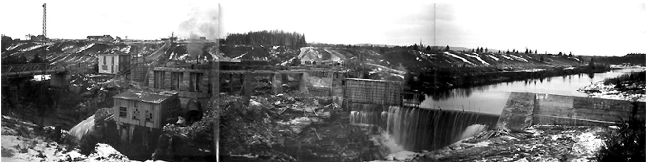
Construction de la centrale de Saint-Alban 1. Source : Collection Action plans d'eau plein air.
