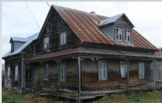
Une maison en bois mal entretenue et non peinte se dégrade rapidement.
