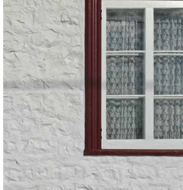
Crépi revêtant un mur de maçonnerie laissant entrevoir la texture de la pierre, Grondines
