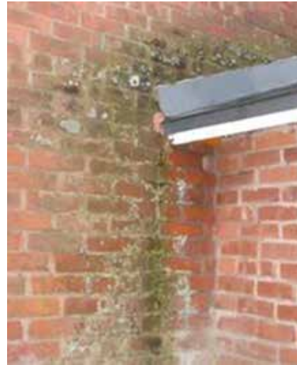
Mur de brique altéré par l'eau en raison de l'absence de gouttières
