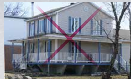
Nouvelle fondation en béton trop haute. Il est recommandé de cacher le dessous de la galerie et les supports de béton par une jupe de galerie ajourée.
