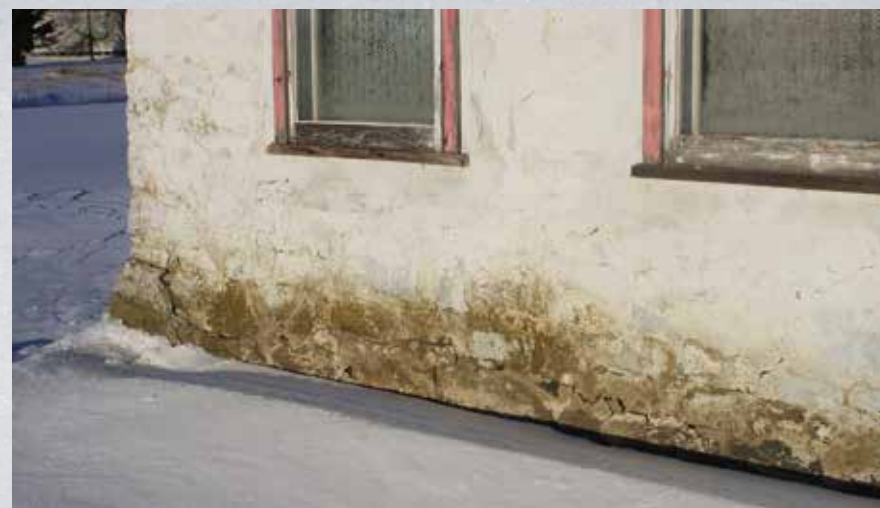
Ce crépi, fissuré et délavé à la base d'un mur, a grandement besoin d'être restauré.
