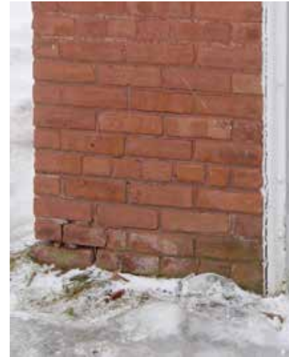
Mur de maçonnerie dont les rangées de brique inférieures ont besoin d'un rejointoiement
