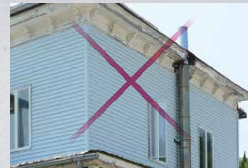
Cheminée tubulaire en acier inadaptée à l'architecture ancienne. Modèle à éviter
