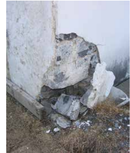
Coin de mur en pierre disloqué qui nécessite une réparation urgente afin de consolider la structure
