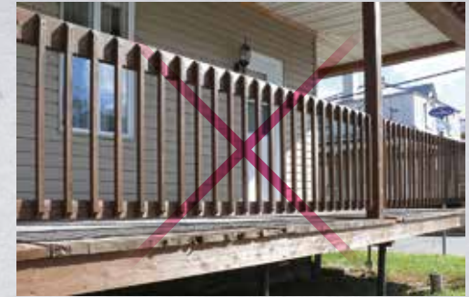
Garde-corps préfabriqué en bois avec barreaux fixés aux flancs de la main courante et de la lisse basse. Modèle à éviter
