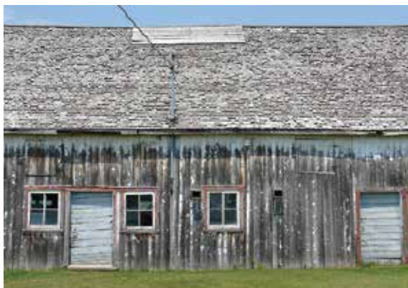
Grange-étable entièrement en bois (toiture, murs, ouvertures) qui a besoin d'entretien, Grondines
